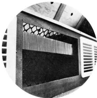
radiatorvärme med cirkulationspump och termostat i SMV
